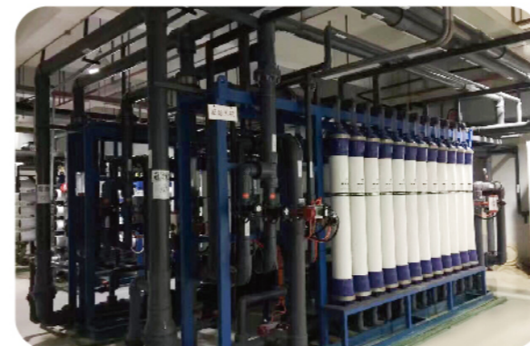
电子行业回用水项目 Electronic industry water reuse project
